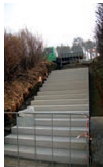
Původní schody byly v dezolátním stavu
